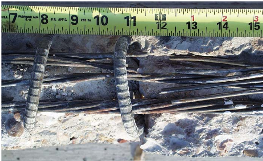
Figure N.19 Photo of Wire Failures in Beam 6 – Location B
