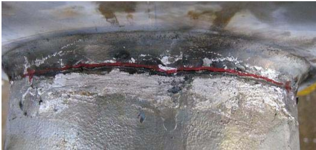
Figure 4.4.6 Highlighted Fatigue Crack on Mast Arm TXuCLGP Weld Toe Along the UIT Application
